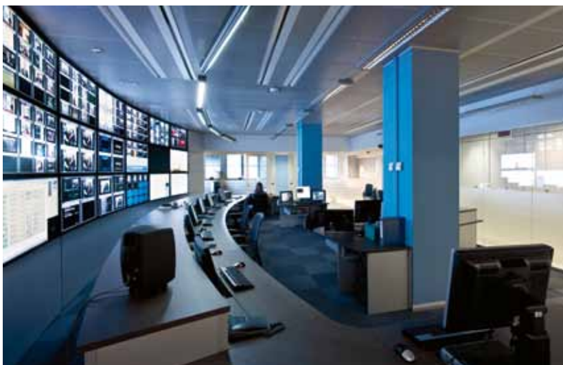
CONTROL ROOM DI UN OPERATORE TELEFONICO E TELEVISIVO, PROGETTO SIEMENS E UFFICIO TECNICO SACEA
